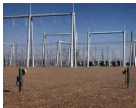
変電所設置例
